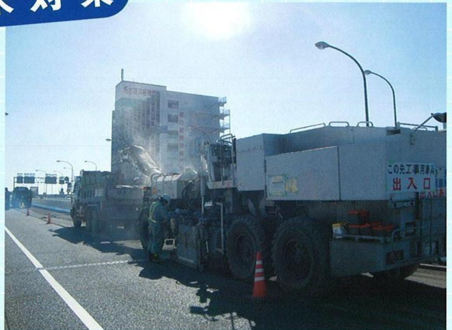
粉じん未対策での施工
